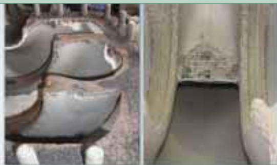
Пример точечной коррозии
