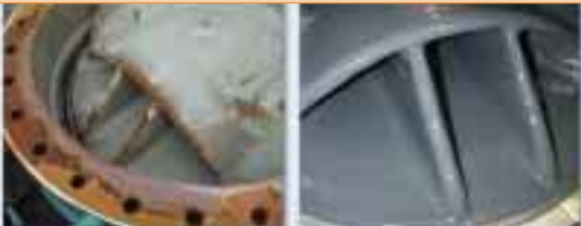
Поврежденный дроссельный клапан – до и после ремонта
